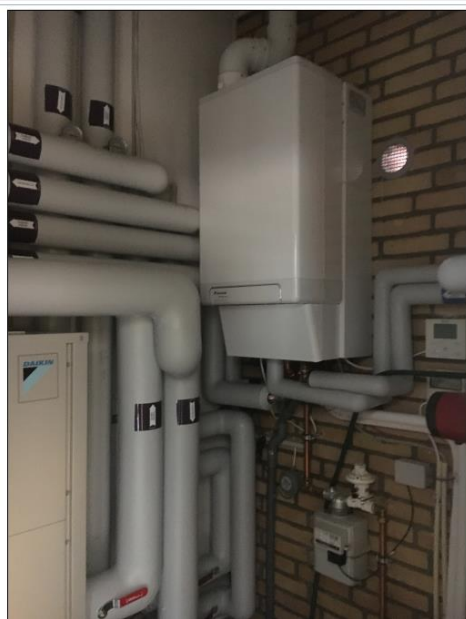
Hybrid ophængt i rengøringsrum.
