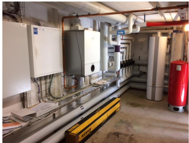
Tilslutningsledninger fra udedel, VVB, gaskedel og styreskab.
